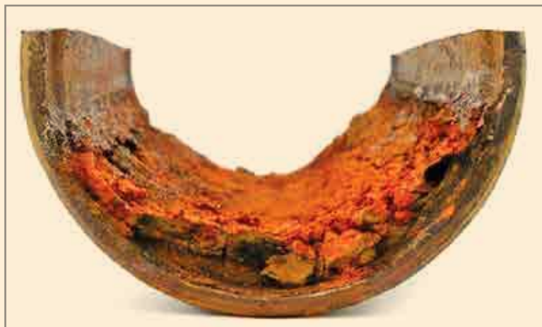
شکل (۲) مشاهدات به عمل آمده از سطح داخلی یک قطعه لوله فولادی بریده شده انتقال آب
